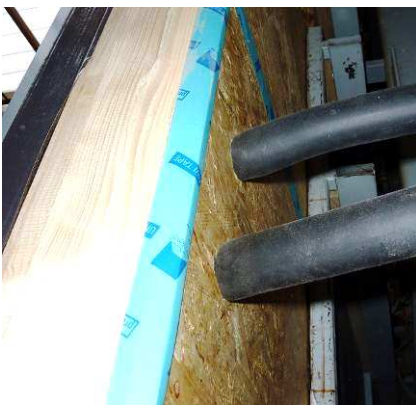
Leitungsdurchführung am Element von innen
